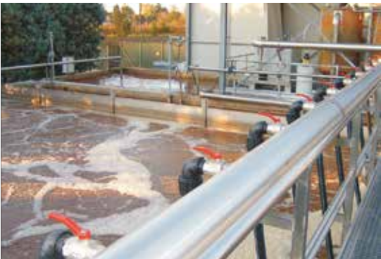
En la imagen se muestra 1 depósito en hormigón proyectado con la función de desnitrificación y oxidación.
